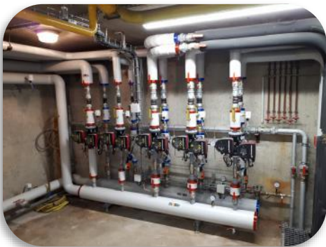
Nouvelle Panoplie de distribution
