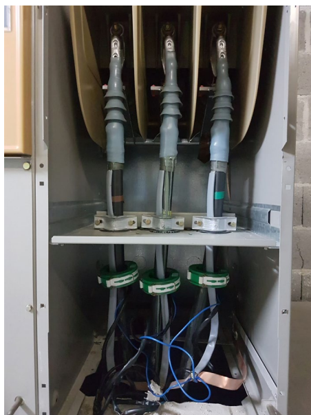
Tores homopolaires sur câbles
